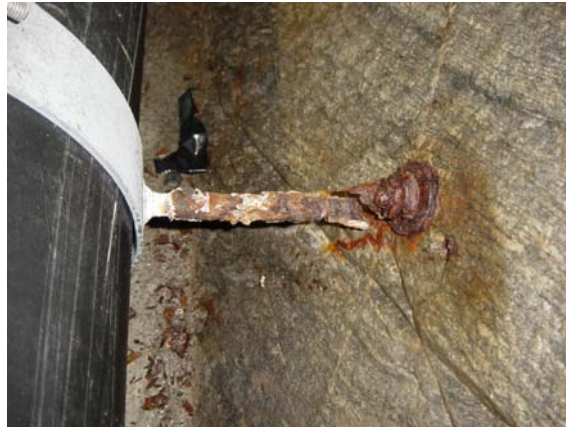
Abb.21: Korrosion Halterungen Abwasserleitung
